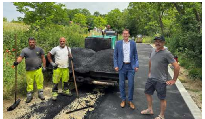
Bgm. Alexander Raicher und Ortsvorsteher Franz Gschwent zu Besuch bei den Abschlussarbeiten durch die Firma Leithäusl
